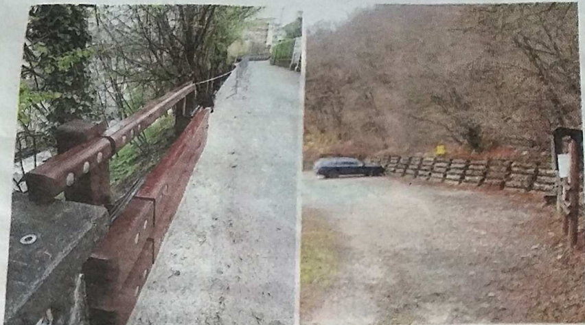
A sinistra l'intervento di sistemazione in via Diziani, a destra il parcheggio alle Case Bortot
