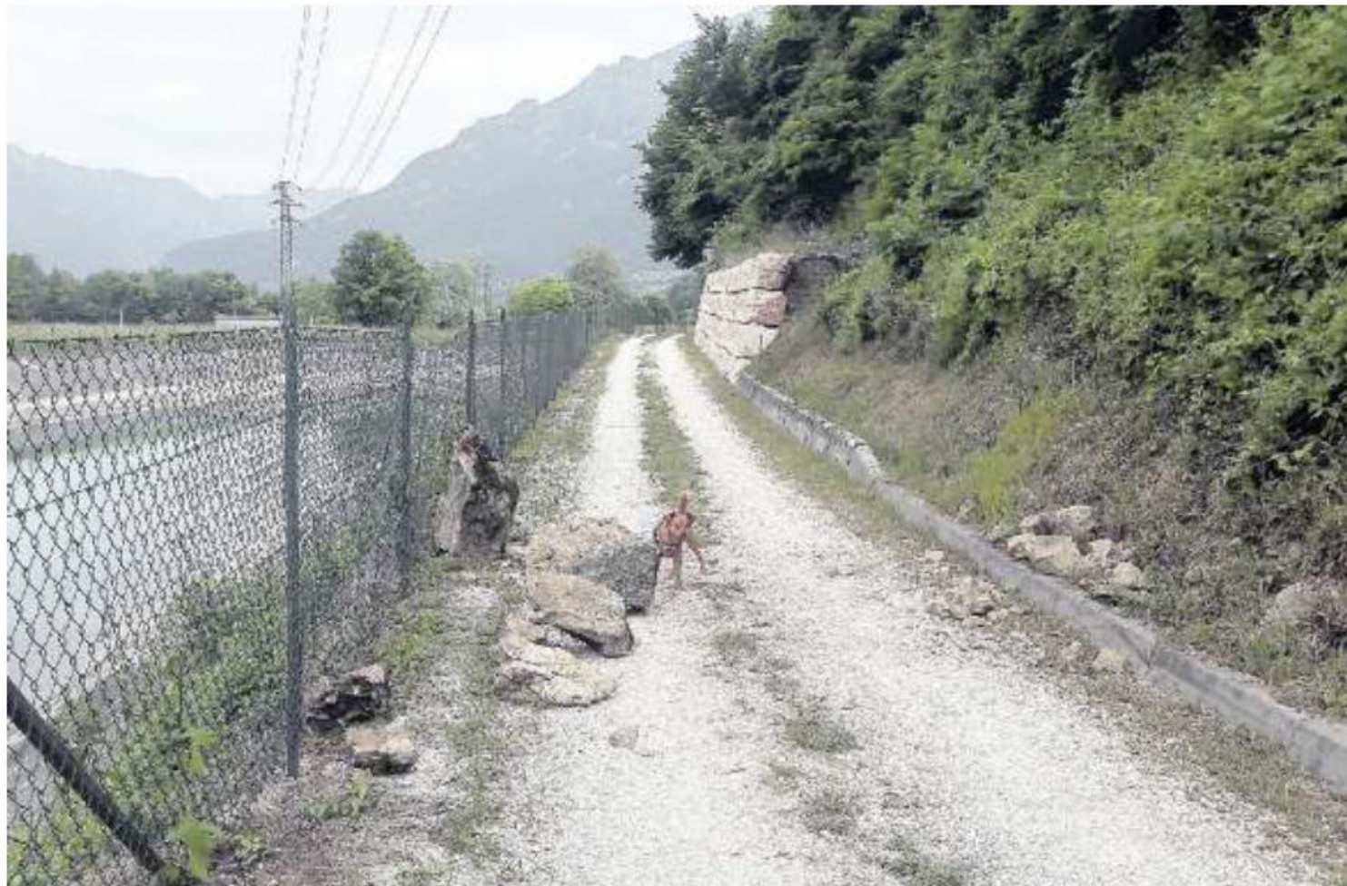
ALPAGO Continuano i distacchi di materiale da un tratto di versante che sovrasta la ciclabile lungo il Cellina
